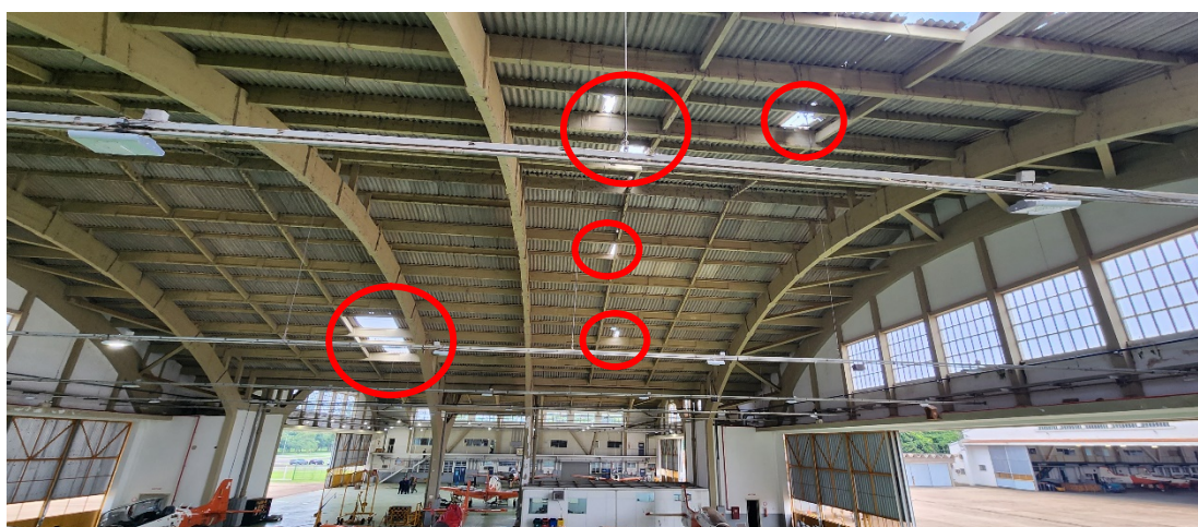
Figura 8- Diversos pontos com telhas quebradas no H-03.
