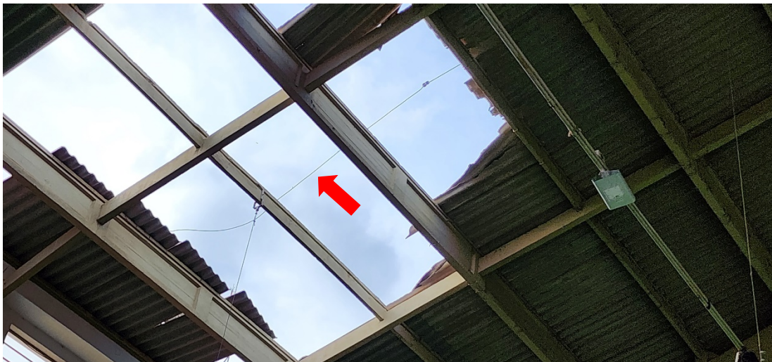
Figura 13- Detalhe do desprendimento do cabo da malha de proteção do SPDA no H-03.
