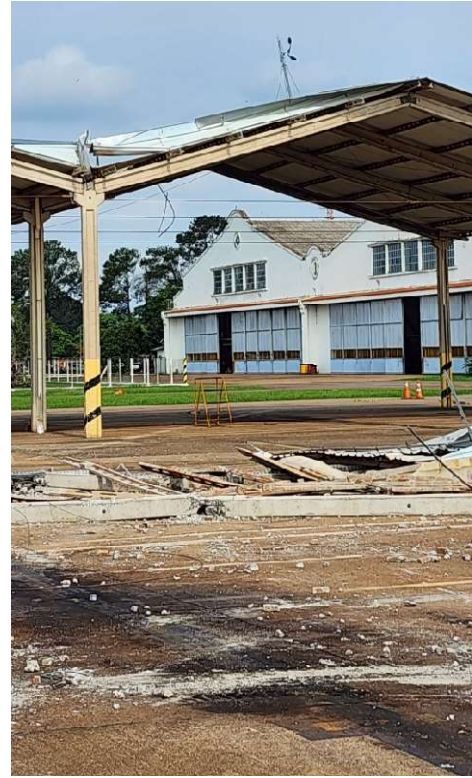
Figura 7 - cobertura danificada na linha de hangaretes 1 a 10
