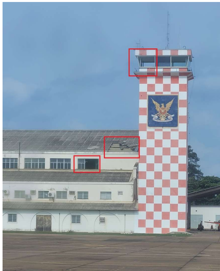
Figura 17- Vista externa do H-05. Avarias na Janela do Hangar, Torre e destelhamento.
