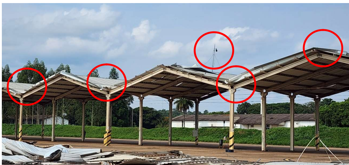
Figura 10: Detalhe do telhado metálico danificado. Avaria da malha do SPDA, captor e sinalizador de obstáculo.
