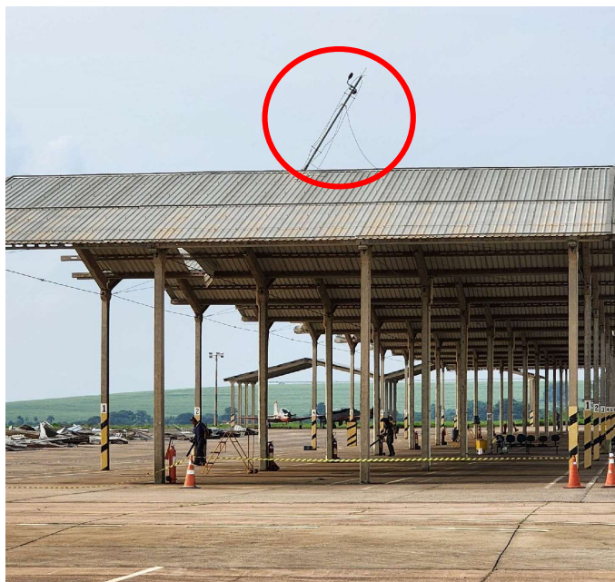
Figura 8- Detalhe do SPDA, avaria do captor tipo Franklin.
