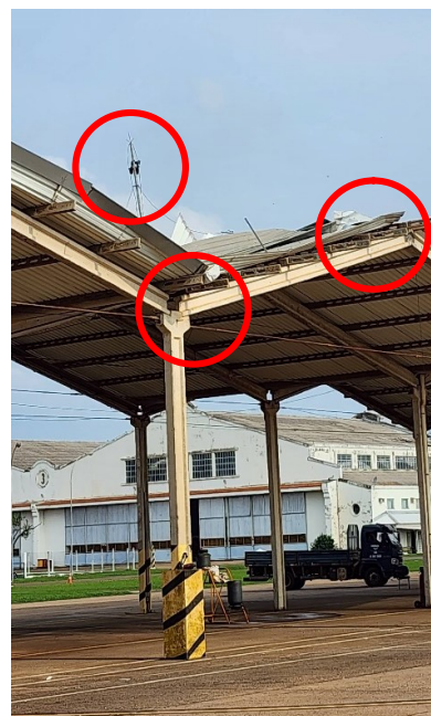
Figura 9: Danos no sistema de descida e da malha SPDA.
