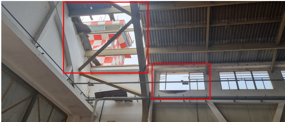
Figura 116- Ponto de avaria no telhado e Janela do H-05.
