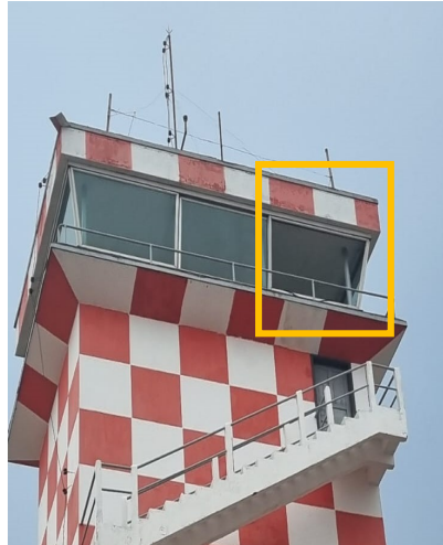
Figura 128- Avaria em Janela da Torre de Controle.
