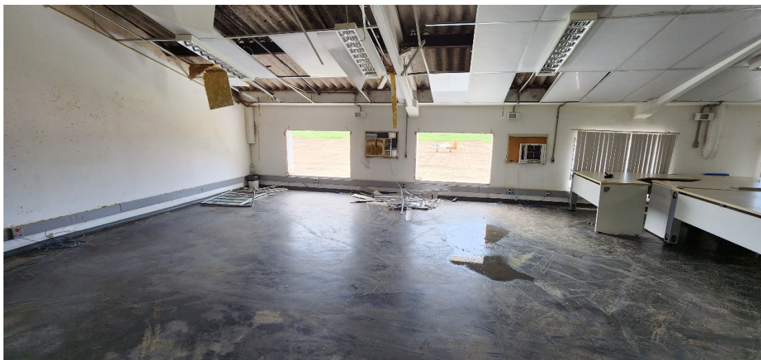
Figura 10- Vista interna da sala do H-03 onde houve avaria das janelas, forro e divisórias.
